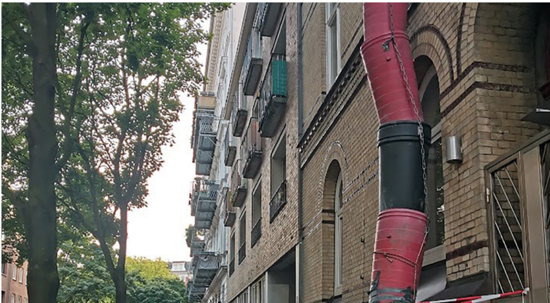
Bild: Ein sehr anschauliches Beispiel einer falsch gesicherten und somit gefährlichen Baustelle auf einem Gehweg, die uns so fast tagtäglich im Leben begegnet.
